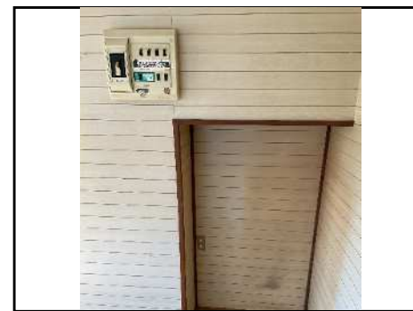
コンセント・ブレーカー
