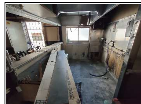
1F店舗部分(キッチン)
