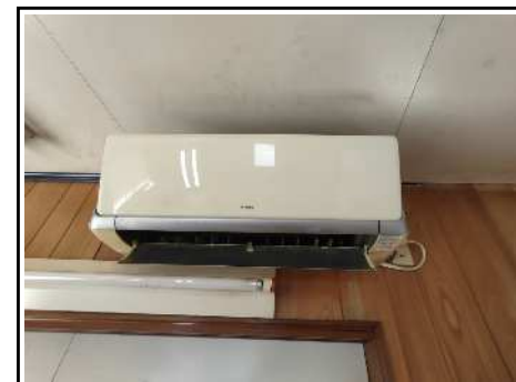
店舗部分(エアコン)
