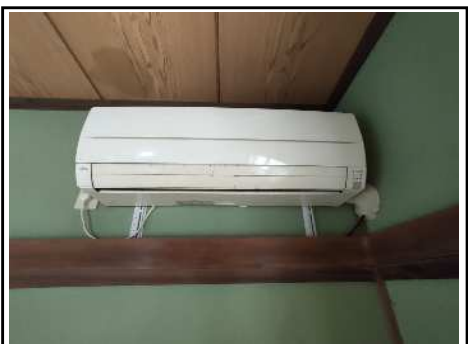
住居部分(エアコン)
