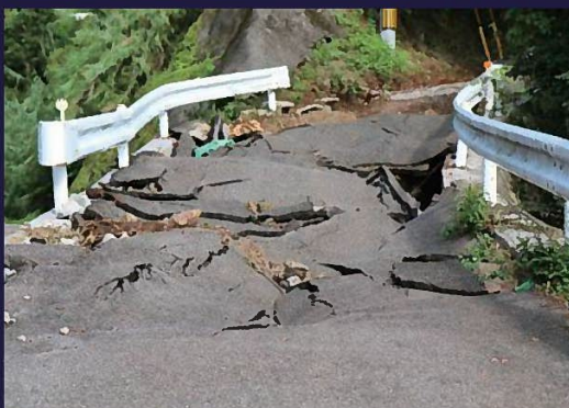
陥没した道路(深江地域)
