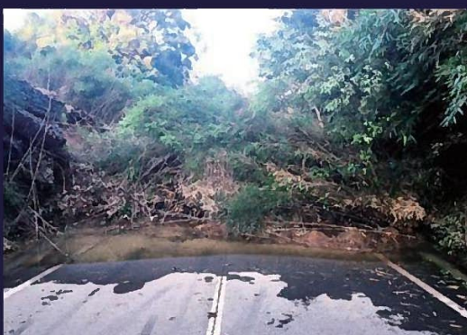
土砂と崩れた立ち木でふさがれた道路(野津・筒井本線)
