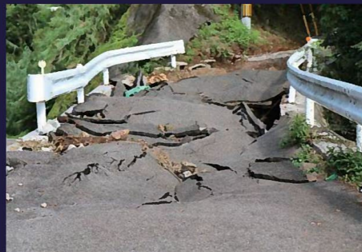
陥没した道路(深江地域)
