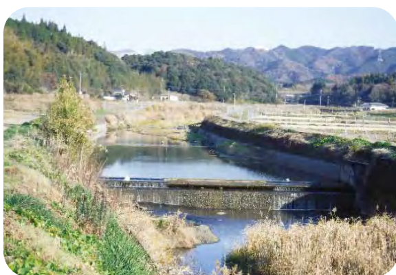
老朽化した頭首工
