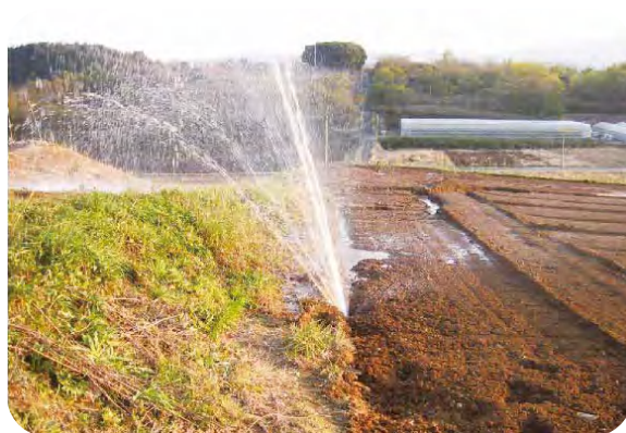
石場ダムパイプラインの漏水状況
