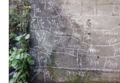
橋台：ひびわれ
